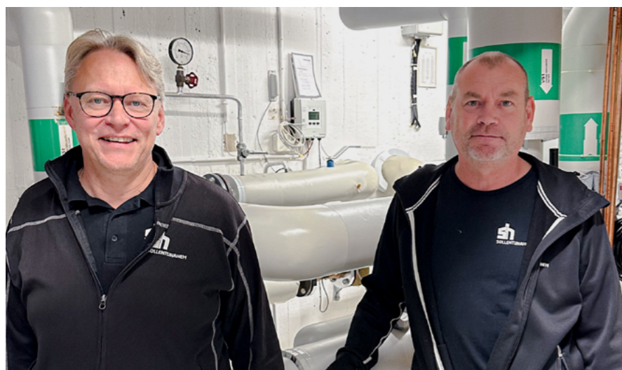
Driftteknikerna Johan och Robert gör ett besök i en av undercentralerna i en fastighet.
