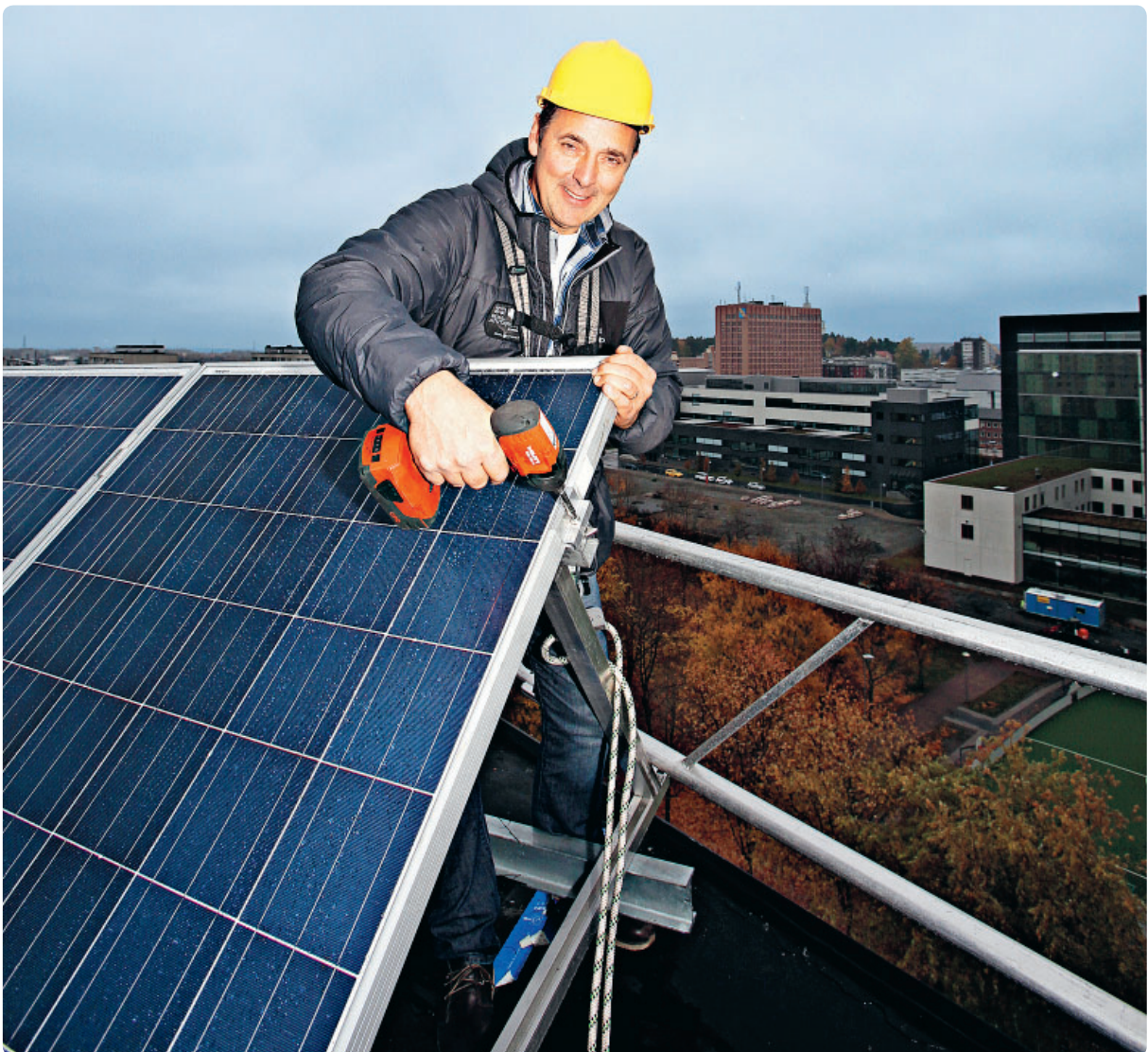
Solenergipaneler på Malmvägen.
